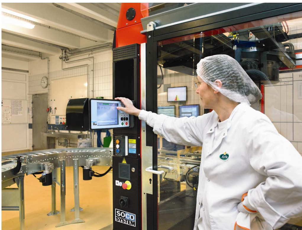
(SOCO_System_Arla_Foods_30.jpg): Operatør Søs Nielsen er fornøjet med brugervenligheden på touchskærmen og lynhurtig aktivering af nye pallemønstre.
